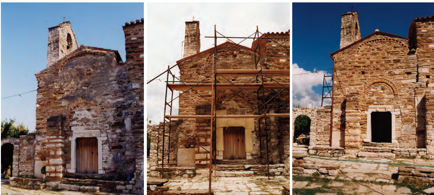
Εικ. 239. α, β, γ. Νότια πλευρά του ναού πριν, κατά τη διάρκεια και μετά τις εργασίες (2004-2006).
