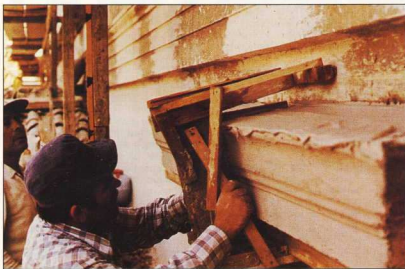
5. Από το εργοτάξιο της Διεύθυνσης Πολιτιστικών Κτηρίων και Αναστηλώσεως Νεωτέρων Μνημείων στο κτήριο της Παλιάς Βουλής.
