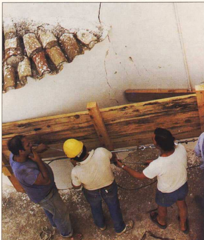
4. Άμεσα μέτρα στερέωσης σε σεισμόπληκτο μνημείο της Μεσοασίας.
