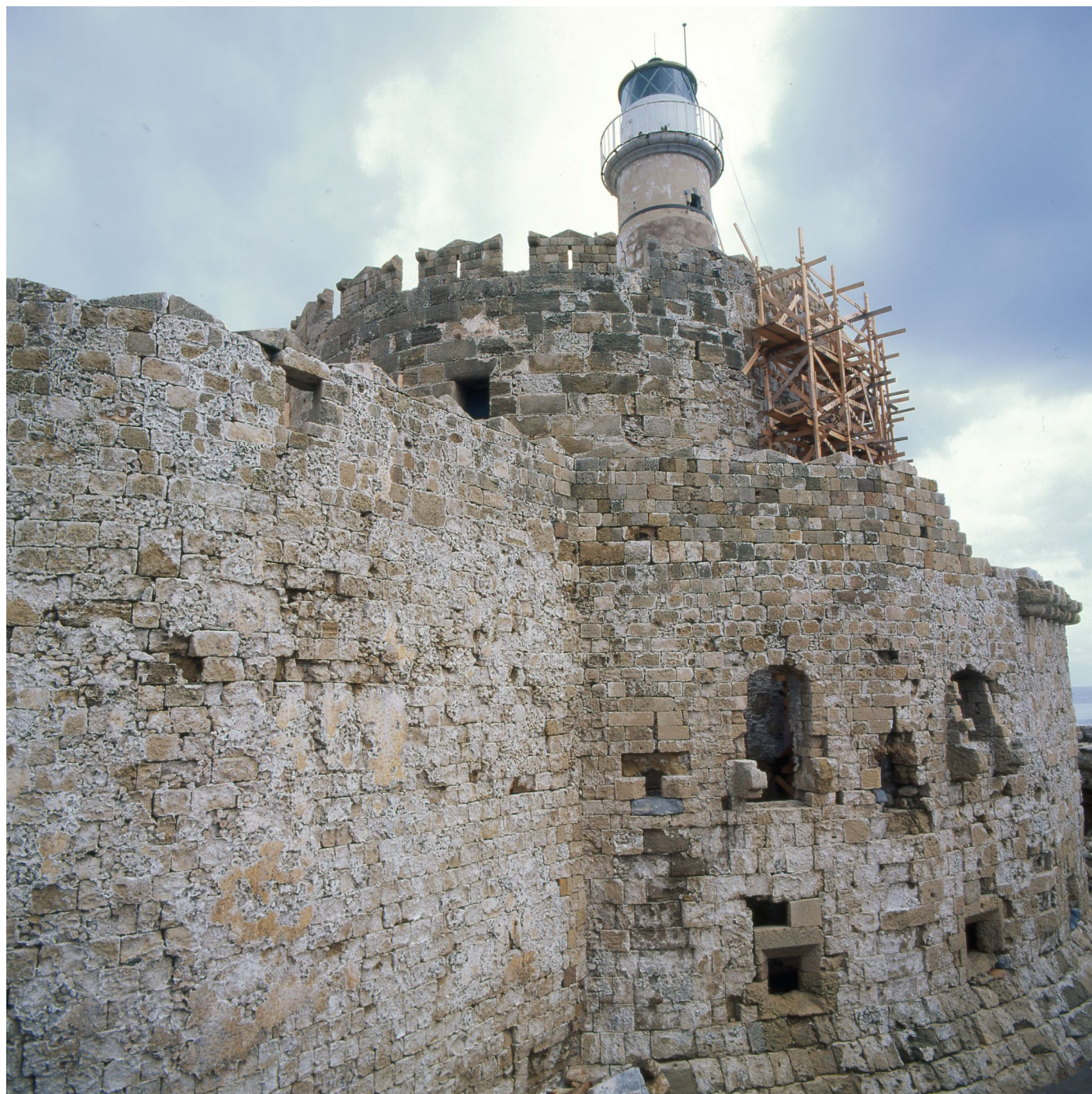
Εικ_09. Άποψη επικίνδυνου τμήματος του πύργου Zacosta πριν την επέμβαση.
