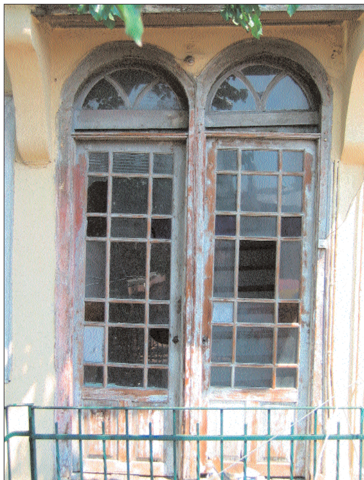
6. Κεντρική είσοδος στάθμης α' ορόφου. Παρατηρείται η έντονη παραμόρφωση του ανοίγματος.
