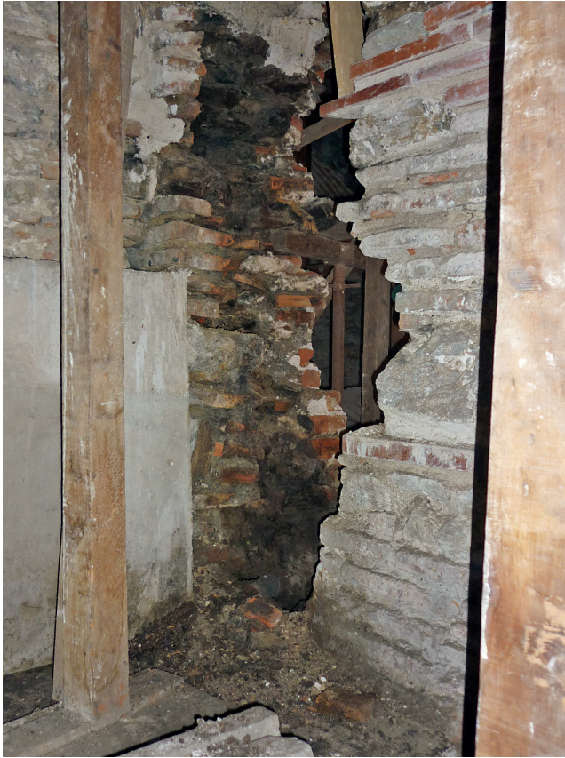
Εικ. 23. Καθ' ύψος διαμπερής καταστροφή της τοιχοποιίας που άρχιζε από τη στάθμη των υποκαύστων και έφτανε ως το επίπεδο των στεγών.
