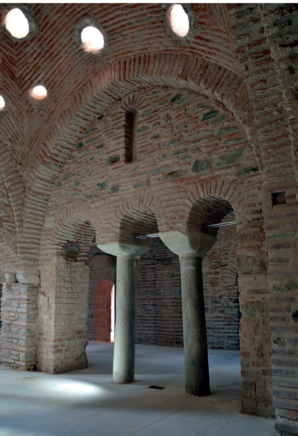
Εικ. 39. Εσωτερική άποψη του θερμού χώρου (θερμολουτήριον) μετά τις εργασίες στερέωσης - αποκατάστασης.
