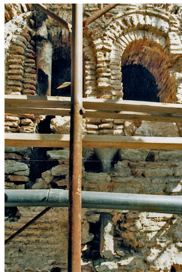
Εικ. 18. Το δίλοβο παράθυρο του χλιαρού χώρου πριν τις εργασίες στερέωσης - αποκατάστασης. Fig. 18. The two-light window of the warm room before the restoration - consolidation project.
