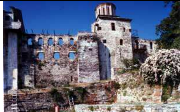
Εικ.12. Νότια Οψη μετά την πυρκαϊά.
