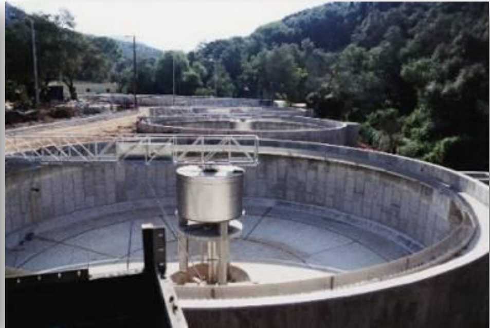
Εσωτερικό δεξαμενής – Κώνος συγκέντρωσης ιλύος – Ξέστρα πυθμένα
