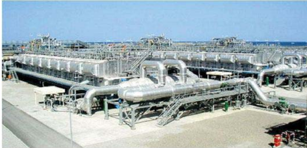
Σχήμα 3: Εγκατάσταση πολυβάθμιας εκτόνωσης στη Μέση Ανατολή
