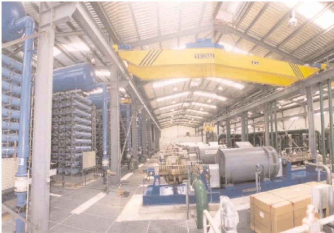
Σχήμα 10: Εγκατάσταση αντίστροφης ώσμωσης (Δεκέλεια Κύπρου, δυναμικότητα 40.000 m 3 /ημέρα)
