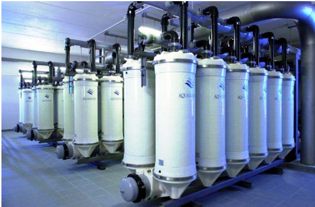
Σχήμα 22: Σειρά μεμβρανών Degremont, παρόμοιες με εκείνες που προορίζονται για τις εγκαταστάσεις αντίστροφης ώσμωσης θαλασσινού νερού (SWRO) οι οποίες, όταν ολοκληρωθούν, θα είναι οι μεγαλύτερες του είδους στο νότιο ημισφαίριο
