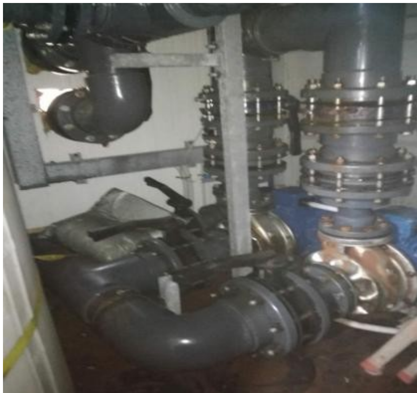
Εικόνα 7.2.6 Φωτογραφίες από συστοιχία αφαλάτωσης με ανοξείδωτους χάλυβες
