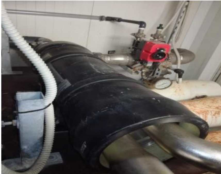
Εικόνα 7.2.13 Αντλία αντίστροφης ώσμωσης στη Μονάδα Αφαλάτωσης της Χίου
