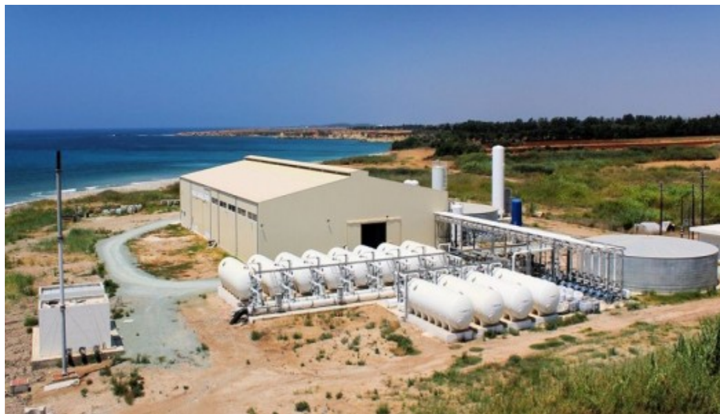
Εικόνα 6 Ενιαία μονάδα αφαλάτωσης στη Μύκονο
