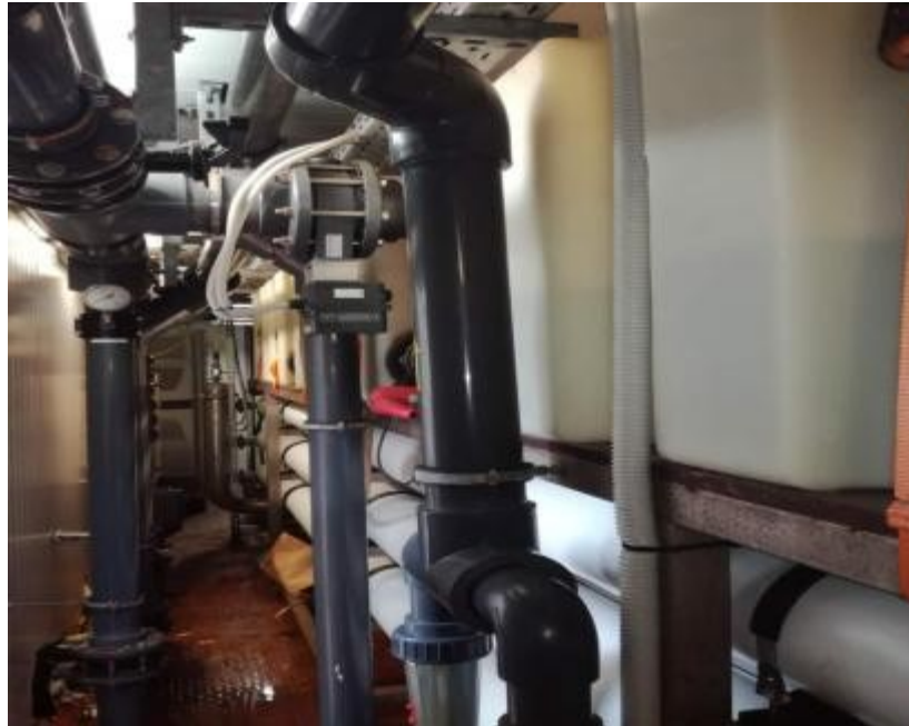
Εικόνα 7.2.1 Φωτογραφία του συστήματος υπερδιήθησης στη Μονάδα Αφαλάτωσης της Χίου
