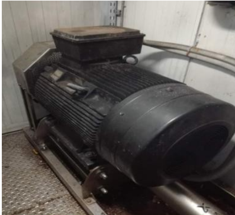
Εικόνα 7.2.7 Οι αντλίες τύπου end-suction της Granados είναι αντλίες πολλαπλών χρήσεων σε μονάδα αφαλάτωσης της Χίου
