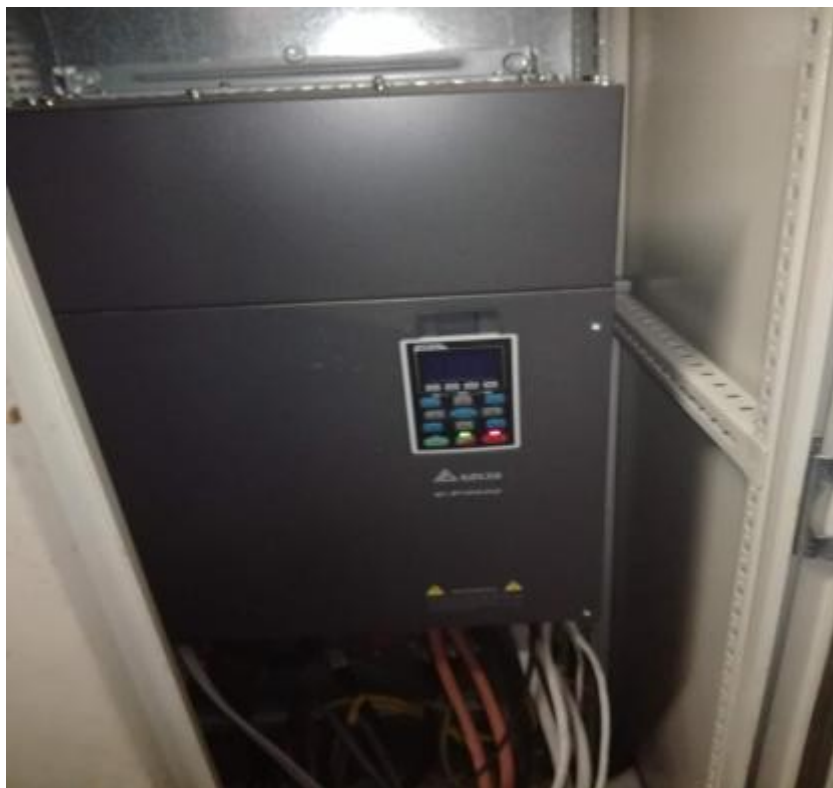
Εικόνα 7.1.5 Πίνακας ελέγχου μεταβλητής συχνότητας της αντίστροφης ώσμωσης της μονάδας Αφαλάτωσης της Χίου
