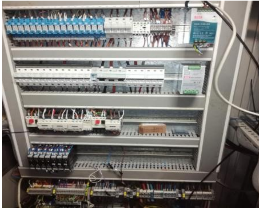
Εικόνα 7.2.10 Κεντρικός πίνακας ελέγχου τη μονάδας της Χίου
