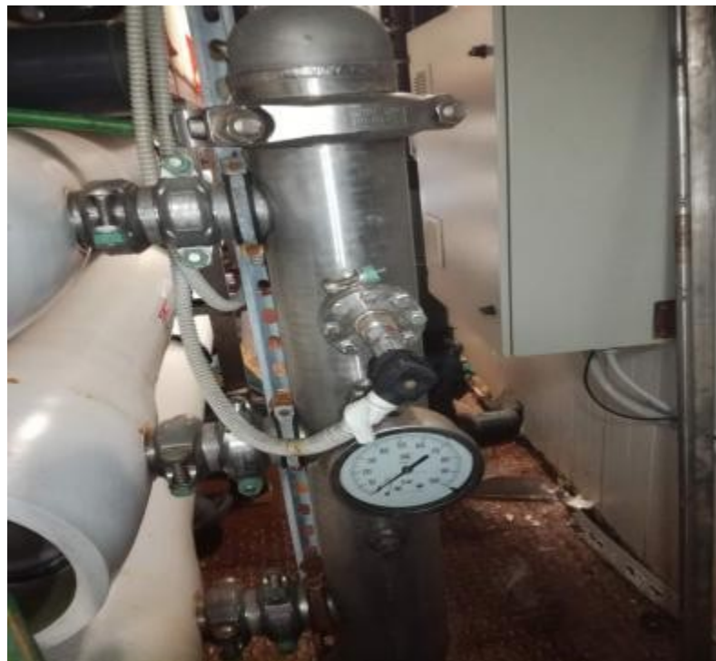
Εικόνα 7.2.2 Φωτογραφίες από μανόμετρο μονάδας αφαλάτωσης της ήλου . Στη πάνω δεξιά και στις κάτω φωτογραφίες φαίνεται το βρεχόμενο από θαλασσινό νερό τμήμα του που έχει υποστεί έντονη διάβρωση.
