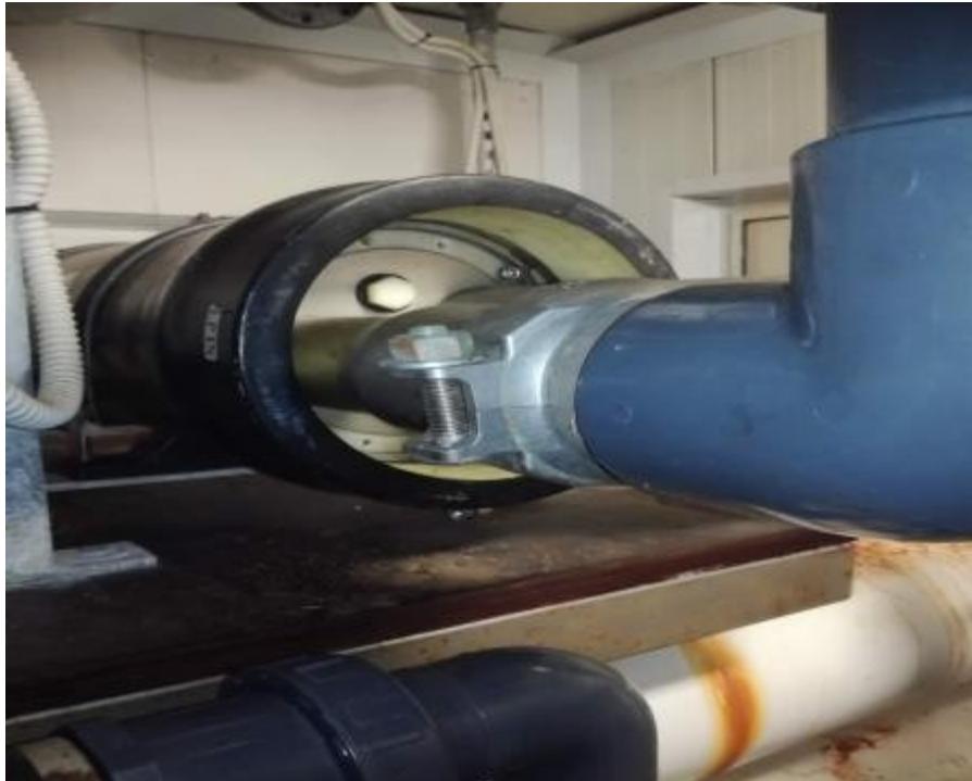
Εικόνα 7.1.4 Αντλία πίεσης με πλευρική είσοδο του νερού τροφοδοσίας στη μονάδα αφαλάτωσης της Χίου
