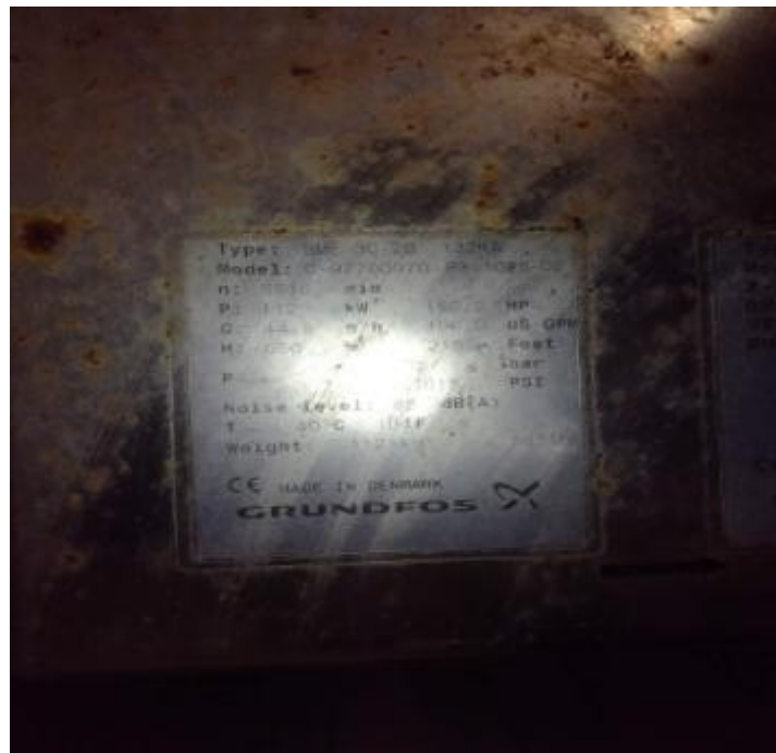
Εικόνα 7.2.3 Πιεστικό συγκρότημα της μονάδας αφαλάτωσης της Χίου τύπου BME (30-20, 132 K)
