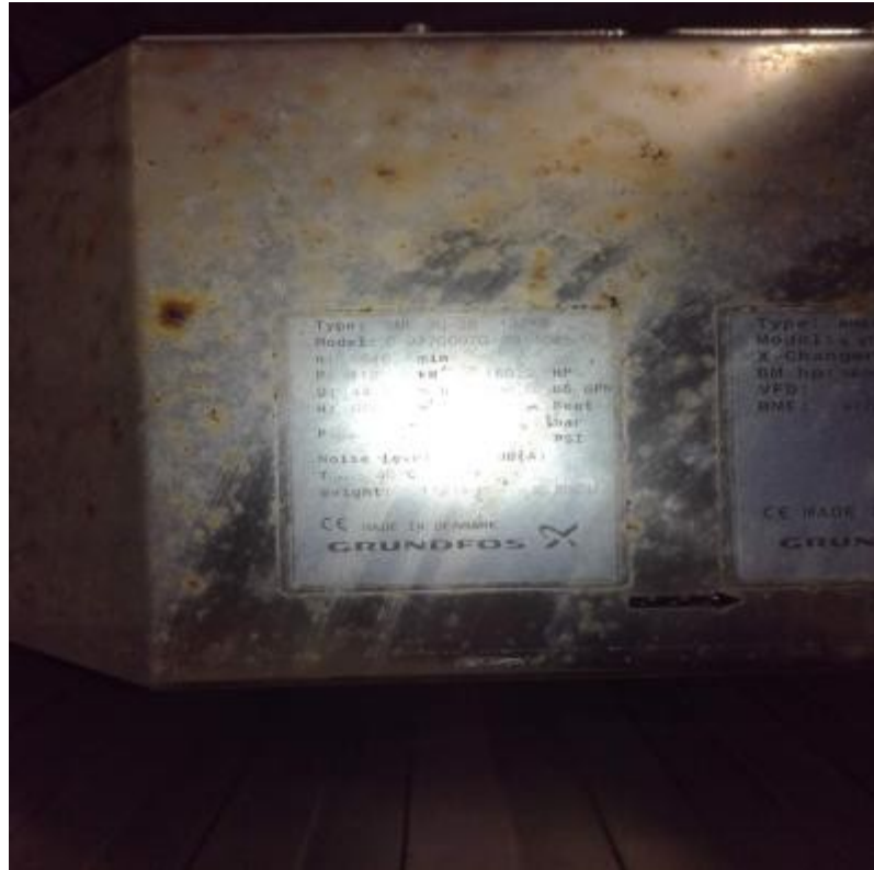
Εικόνα 7.1.6 Πιεστικό συγκρότημα της μονάδας αφαλάτωσης της Χίου τύπου BME (30-20, 132 K)
