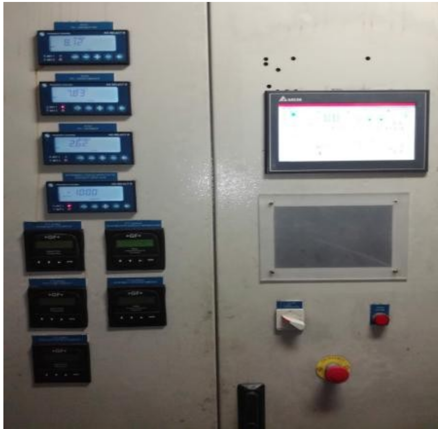
Εικόνα 7.1.2 Πίνακας ελέγχου της μονάδας αντίστροφης ώσμωσης στη Χίου
