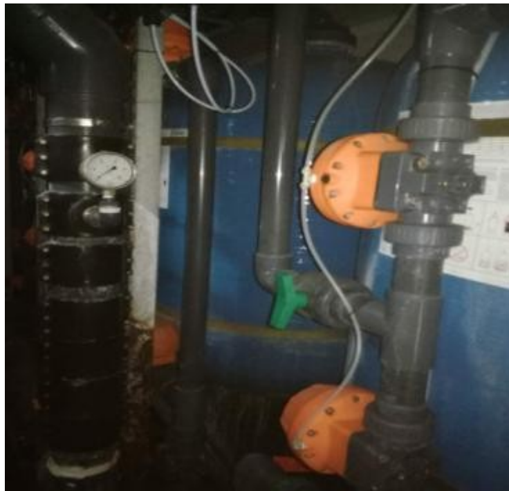
Εικόνα 7.1.7 Φωτογραφία του συστήματος υπερδιήθησης και της μονάδας αφαλάτωσης
