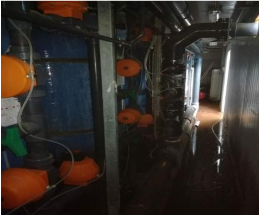
Εικόνα 7.2.5 Φωτογραφίες από συστοιχία αφαλάτωσης μονάδα Αφαλάτωσης της Χίου
