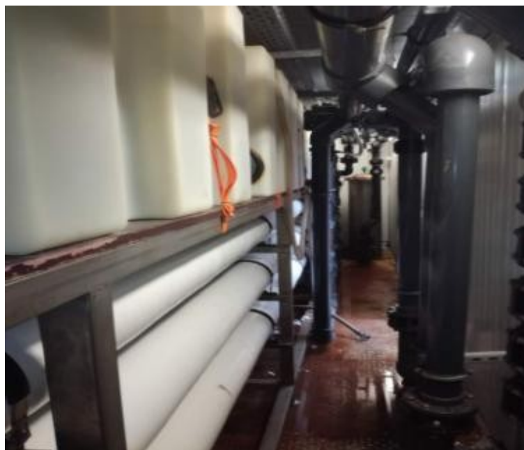
Εικόνα 7.2.4 Φωτογραφίες από συστοιχία αφαλάτωσης μονάδα Αφαλάτωσης της Χίου
