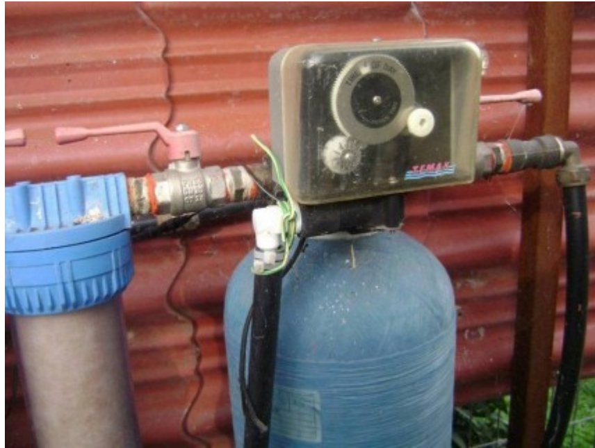
Εικόνα 25: Αποσκληρυντής μιας στήλης (μονός), της εγκατάστασης.
