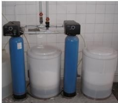
Δίδυμο σύστημα αποσκλήρυνσης οικιακής εγκατάστασης
