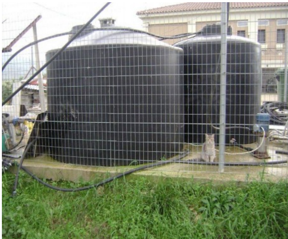
Εικόνα 24: Οι δύο δεξαμενές της εγκατάστασης.
