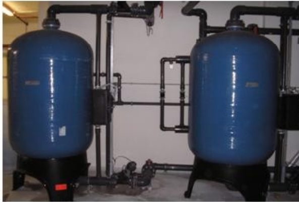
Δίδυμο σύστημα αποσκλήρυνσης βιομηχανικής εγκατάστασης
