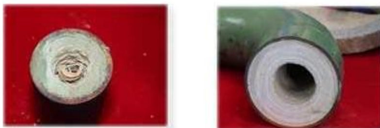
Εικόνα 13: Επικαθίσεις αλάτων σε σωληνώσεις [8,9]
