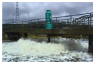
Επιφανειακοί αεριστήρες κατακόρυφου άξονα
