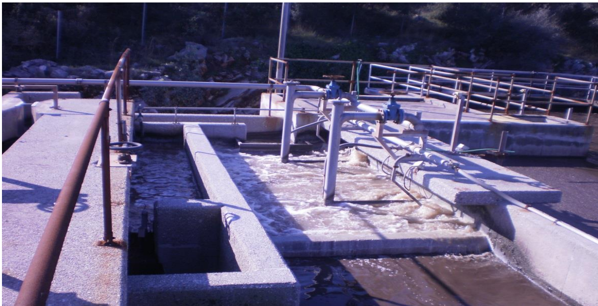
Εικόνα 4.9 Δεξαμενές λιποσυλλογής και αμμοσυλλογής
