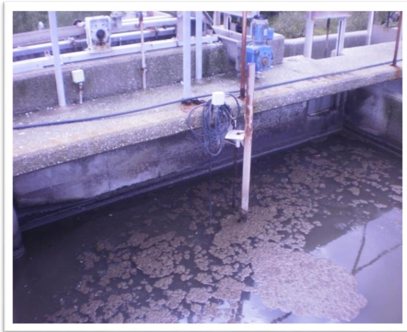
Εικόνα 4.26 Δεξαμενή αποφωσφόρωσης όπου φαίνεται ο υποβρύχιος αναδευτήρας
