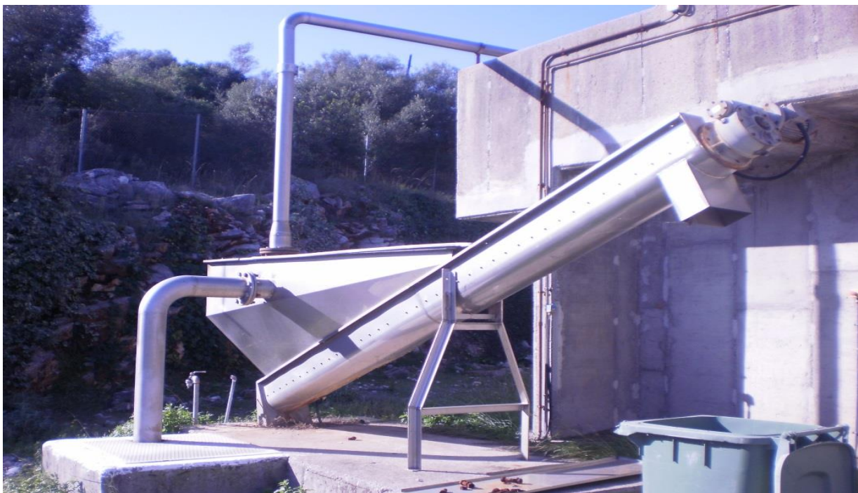
Εικόνα 4.11 Φρεάτιο συγκέντρωσης λιπών
