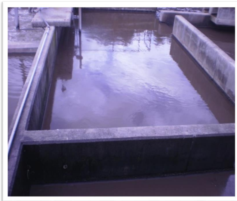
Εικόνα 4.25 Δεξαμενές όπου γίνεται αποφωσφόρωση
