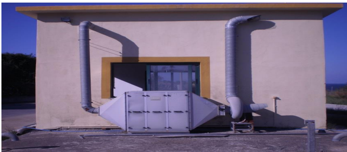
Εικόνα 4.15 Κτίριο βοθρολυμάτων στο οποίο είναι φανερό το σύστημα απόσμησης
