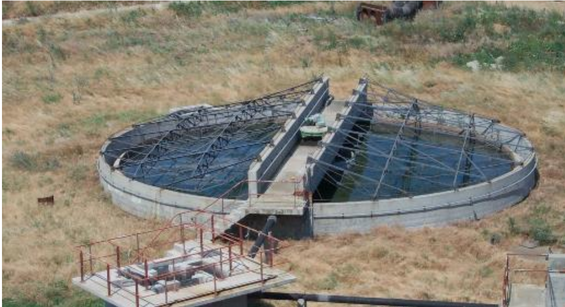
Εικόνα 3.6 Δεξαμενή πάχυνσης με βαρύτητα
