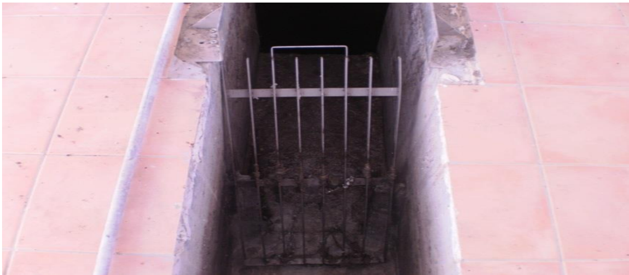
Εικόνα 4.14 Θέση εκκένωσης βοθρολυμάτων
