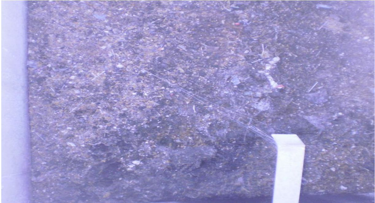
Εικόνα 4.10 Λίπη που επιπλέουν στη δεξαμενή λιποσυλλογής και αισθητήρας
