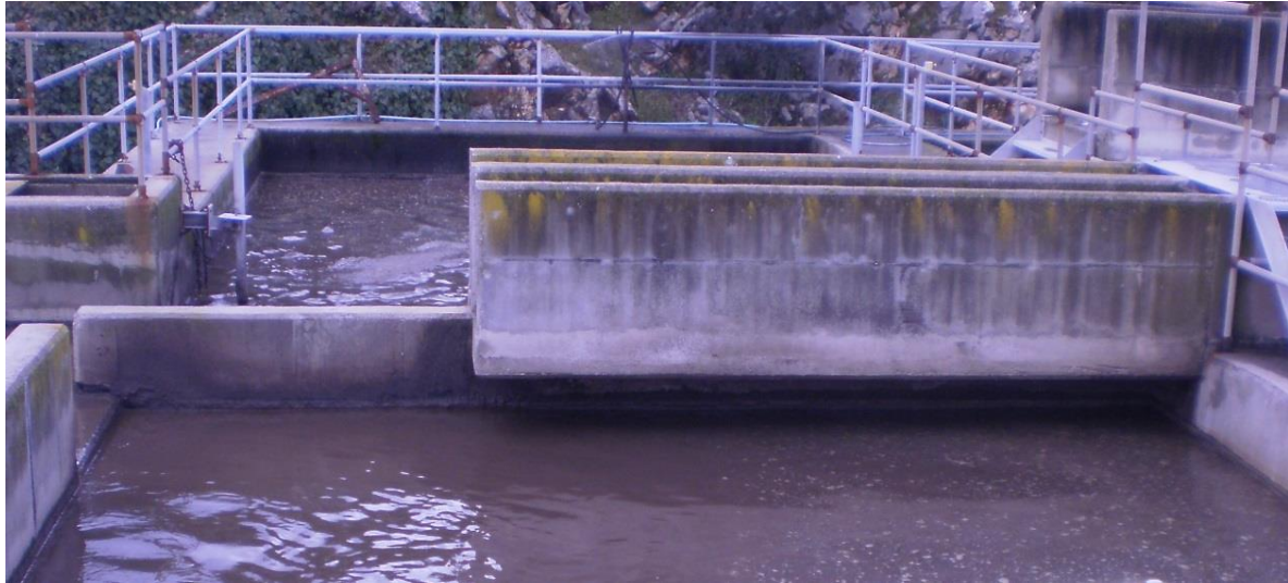
Εικόνα 4.28 Δεξαμενές απονιτροποίησης όπου φαίνονται και τα δύο κανάλια που μεταφέρουν το ανάμικτο υγρό από την δεξαμενή αερισμού σε αυτές
