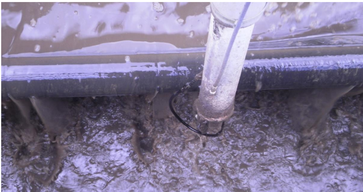
Εικόνα 4.20 Υπερχειλίση δεξαμενής αερισμού
