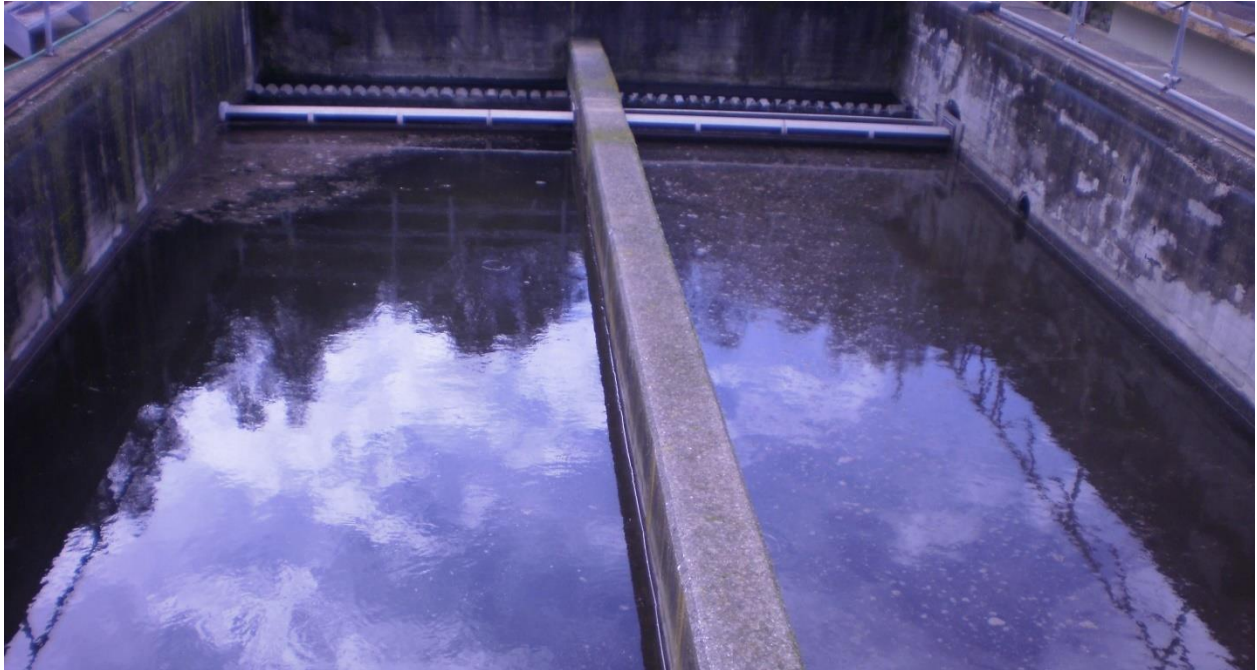
Εικόνα 4.21 Ορθογωνικές δεξαμενές δευτεροβάθμιας καθίζησης
