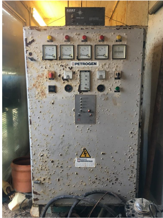
Εικόνα 14.1. Πίνακας ελέγχου αντλιοστασίου Κ1.
