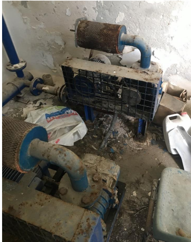
Εικόνα 14.5. Εξοπλισμός εντός μονάδας προεπεξεργασίας ΕΕΛ.
