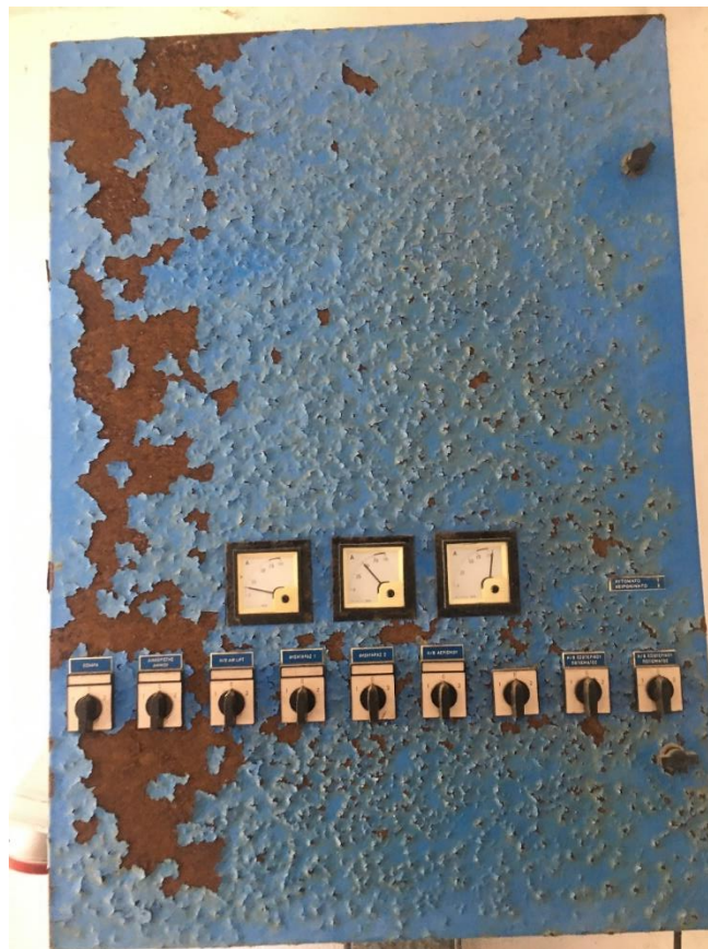
Εικόνα 14.6. Πίνακας ελέγχου στη μονάδα προεπεξεργασίας.
