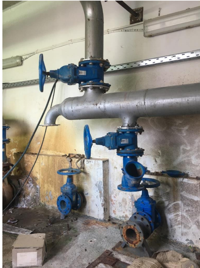
Εικόνα 14.3. Εξοπλισμός αντλιοστασίου K2.
