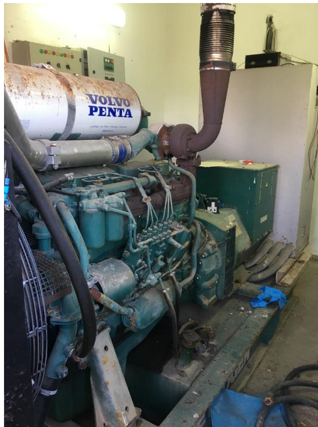
Εικόνα 14.4. Εξοπλισμός αντλιοστασίου K2.
