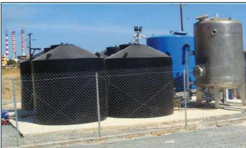
Εικόνα 55 : Δεξαμενές προσωρινής αποθήκευσης ακατέργαστου νερού
