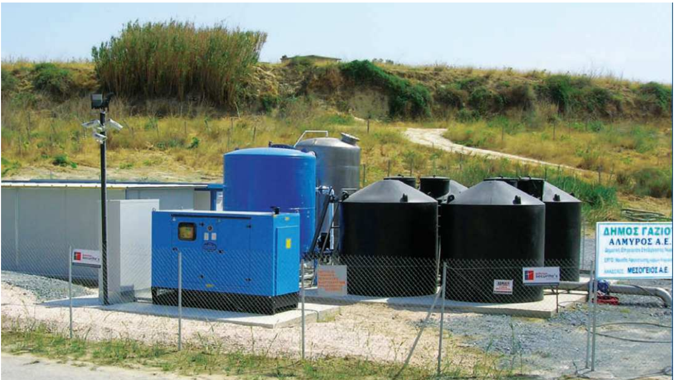
Εικόνα 54: Μονάδα αφαλάτωσης Δήμου Γαζίου
