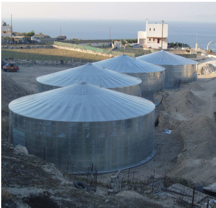
Εικόνα 47 : Καταθλιπτικός αγωγός και δεξαμενες
