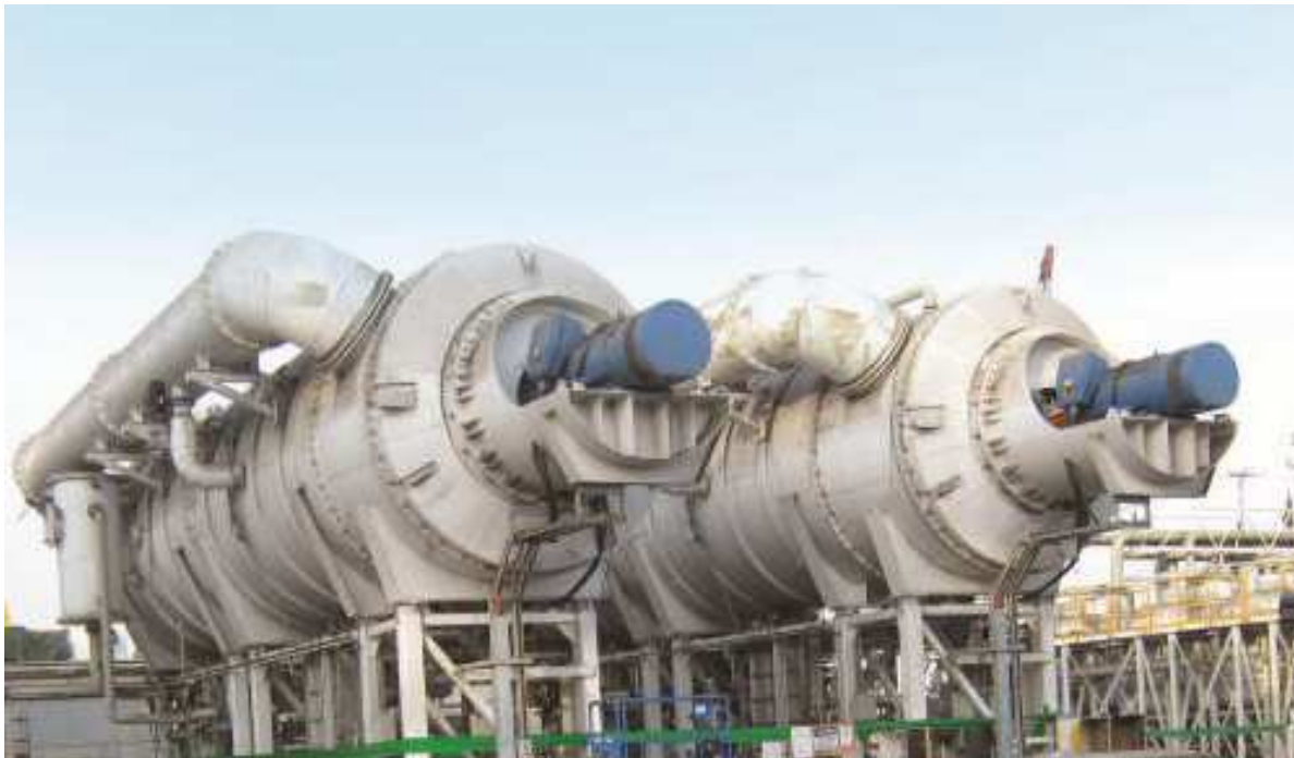
Εικόνα 11: Εγκατάσταση εξάτμισης με συμπίεση ατμών
