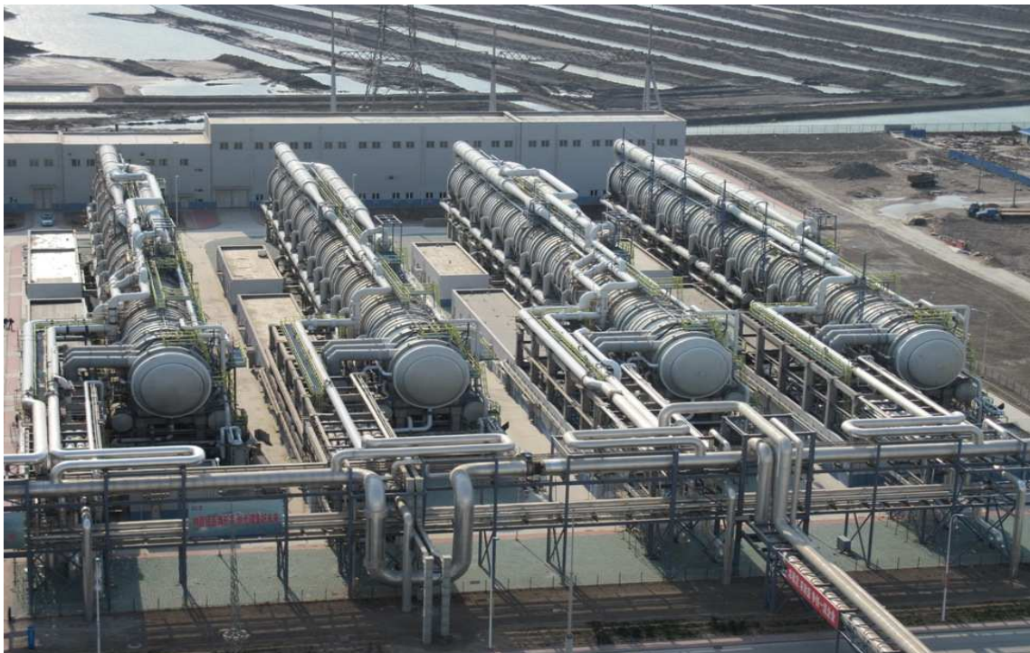
Εικόνα 8 : Εγκατάσταση πολυβάθμιας εξάτμισης στη Κίνα
