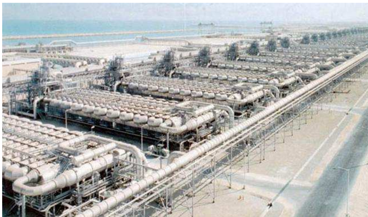
Εικόνα 9: Εγκατάσταση πολυβάθμιας εκτόνωσης στη Σαουδική Αραβία
