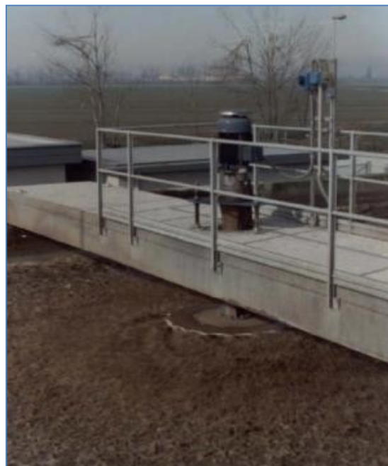
Εικόνα 1.12: Κατακόρυφοι Επιφανειακοί Αεριστήρες από Fiberglass.
