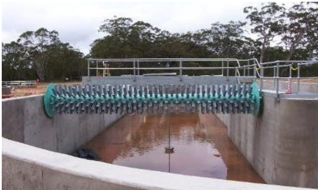
Εικόνα 2.9: Σύστημα αερισμού (α).
