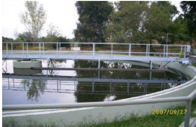
Εικόνα 3.7 Δεξαμενή τελικής καθίζησης
