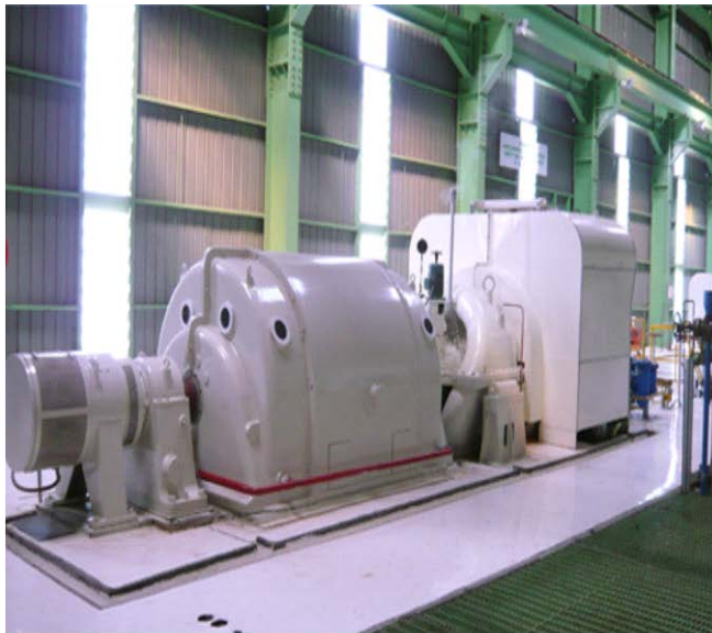
Ατμοστρόβιλος και ηλεκτρογεννήτρια
